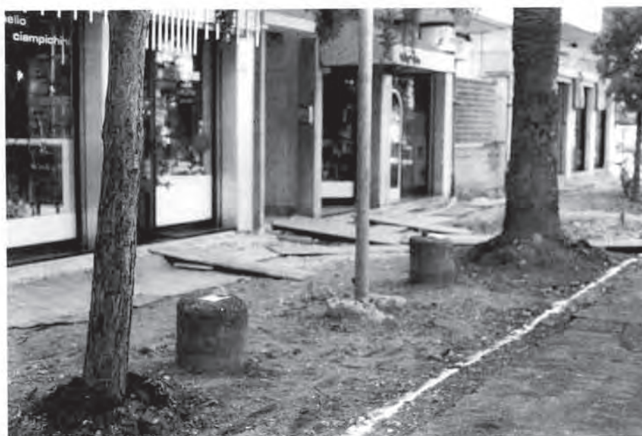
2. PORTO S. GIORGIO - Corso Cavallotti. Fusti di colonne di granito, venuti in luce durante recenti lavori di sistemazione urbana (foto E. Catani).
