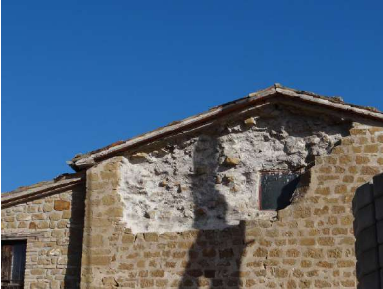
Figura 8 - Il Santuario di Garufo post sisma (fonte studio Bocci and Partners s.r.l.) - danni al timpano (facciata)
