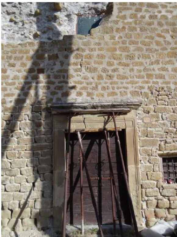
Figura 6 - Il Santuario di Garufo post sisma (fonte studio Bocci and Partners s.r.l.) - dettaglio facciata
