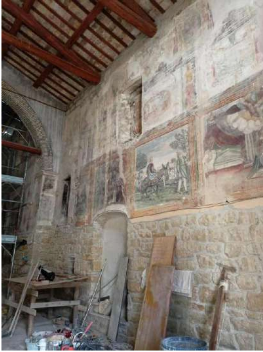
Figura 10 - Il Santuario di Garufo post sisma (fonte studio Bocci and Partners s.r.l.) - danni agli affreschi (interno)
