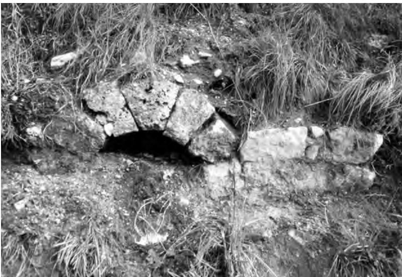
Fig. 78. Pioraco. Strutture di drenaggio idrico di epoca romana presso il centro urbano (SABAP AP-FM-MC).
