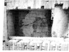
Pareti gravemente danneggiate
