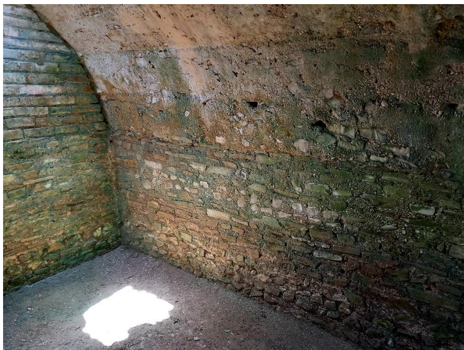
Figura 36 – Cantina voltata. Si notino le fondazioni dei muri perimetrali costituite da ciottoli e l'alzato con filari di tegole e occasionalmente ciottoli. Si vedano le Figure 70 e 71 per un confronto tra le due tecniche.
