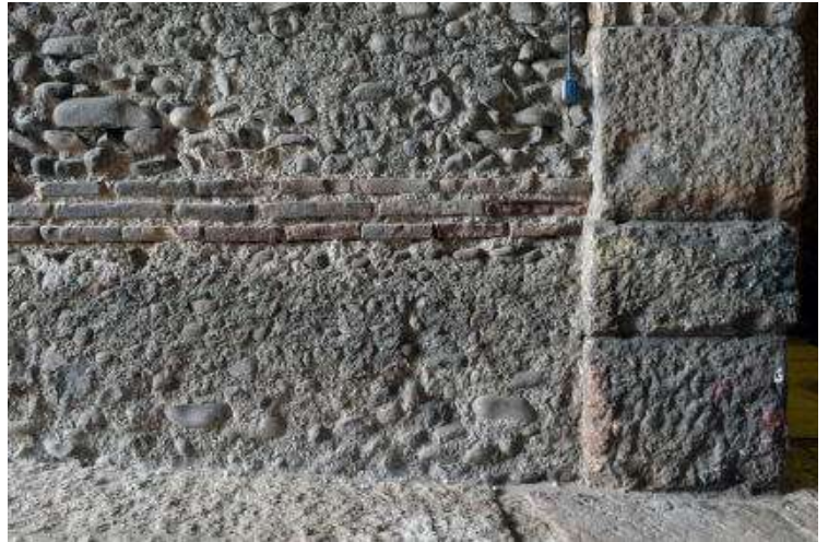
Fig. 9. Arcovolo 30 esterno, parete sinistra: esempio di paramento romano ben conservato, perché rimasto sepolto dall'interramento dell'anfiteatro fino ai primi decenni del XIX sec. Al di sopra della fascia laterizia si nota invece un maggiore degrado delle malte di finitura che scopre i ciottoli.
