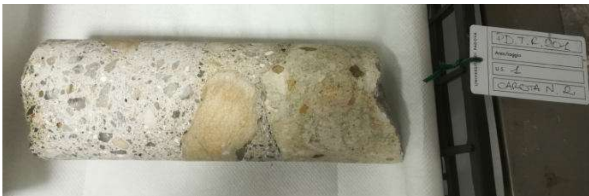
Fig. 13 Porzione sommitale di carotaggio della platea fondazionale in opera cementizia del teatro di Patavium .
