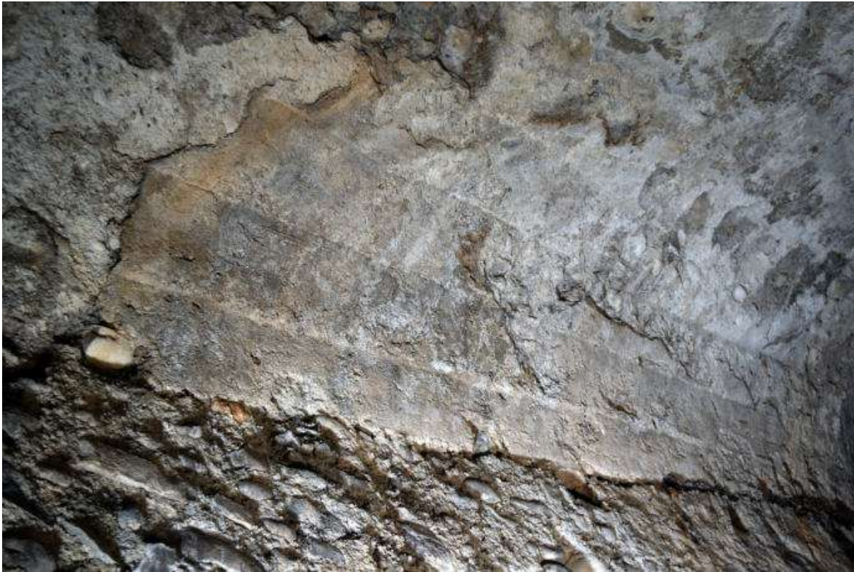
Fig. 12. Arcovalo 67 interno, imposta della volta che conserva le impronte delle assi della centina lignea.
